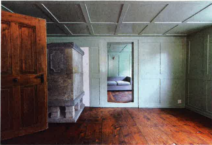
Die Stube – «s Stipli» – weist nur eine Höhe von 1.80 Metern auf. Der alte Kamin musste durch einen neueren ersetzt werden. Erhalten geblieben ist der ursprüngliche Boden, über den bereits der Erbauer des Hauses schritt.
